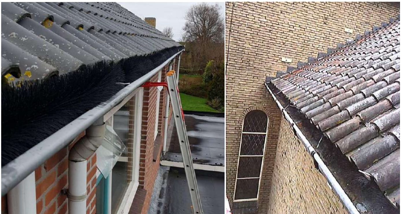
Figuur 6 Voorbeelden ontmoediging dakrand bij dakgoot link spouwborstel in de dakgoot (bron: Unitura.nl) rechts spouwborstel onder dakpannen (Bron: Arcadis)
