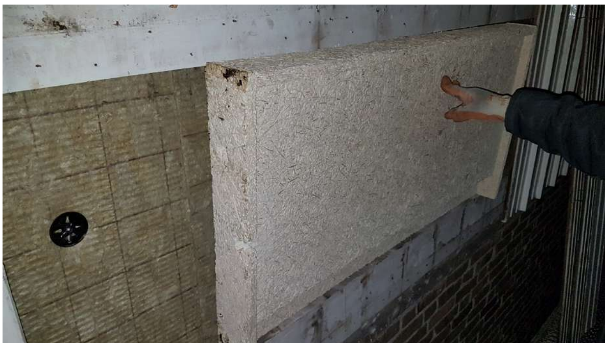
Vleermuisverblijf achter houten betimmering gecombineerd met een op maat gemaakte inbouwkast welke vanachter de gevelbeplating toegankelijk was voor vleermuizen, Breekkers te Son, Woonbedrijf Eindhoven. (Bron: Arcadis)
