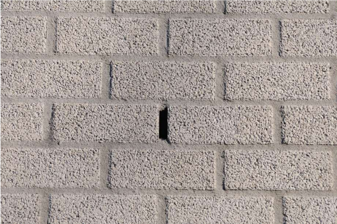
Uitvoeringsvoorbeeld opening spouwmuur met open stootvoeg. Deze is alleen geschikt voor dwergvleermuizen. Voor grotere soorten (o.a. meervleermuis, laatvlieger) dient een groter invliegopening gebruikt te worden (Bron: Ecogroen)
