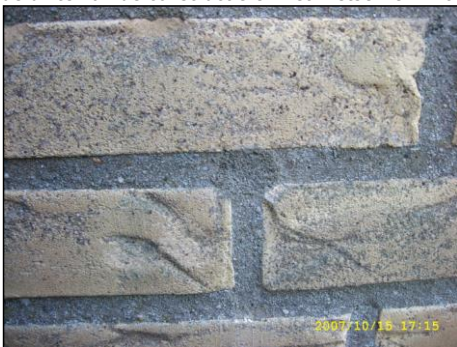
Afb. 3 Boorgat in de gevel
