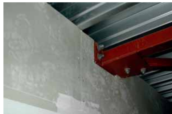
Opening tussen dak en brandwerende wand: geen brandwerende scheiding
