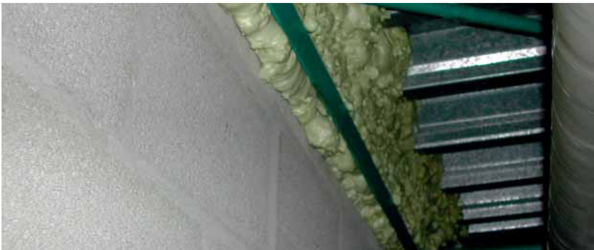
Zowel gewoon-als brandwerend purschuim is niet geschikt bij staaldak- wandovergangen en/of doorvoeringen met metalen elementen.
