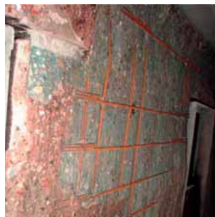
Figuur 3: praktijkvoorbeeld van beton dat van de wapening is afgespat
