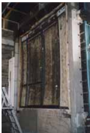
Brandproef van een schuifpui 3,2 m hoogte met brandwerend glas (het brandwerende glas is reeds opgeschuimd).
