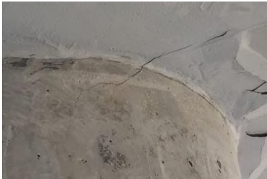
Figuur 33: Scheurvorming door afboeren van de kolom
