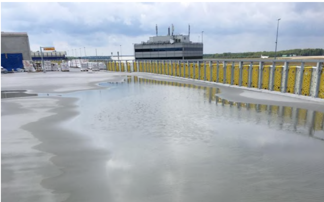
Figuur 11: Plassen op de vierde verdiepingvloer. [033]
