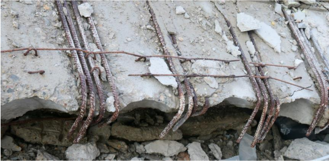
Figuur 15: Uitgetrokken koppelwapening ter plaatse van de primaire breuk. [024]
